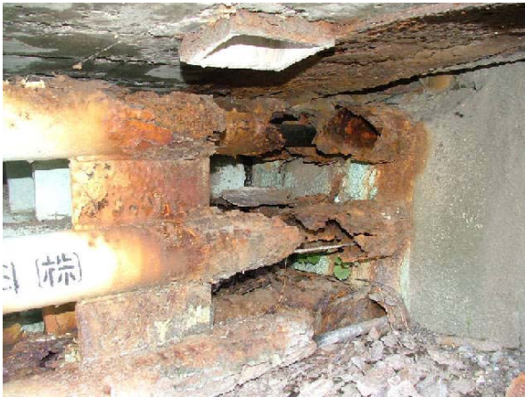
管路腐食状況
