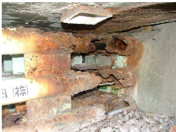
管路腐食状況
